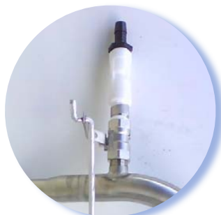
Vanne de purge
